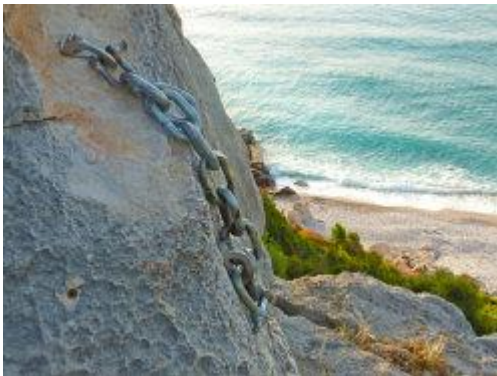
Non sempre l'acciaio zincato arrugginisce. Qui è stata messa una catena zincata su placchette inox ma la catena ed i grilli sono ancora in ottime condizioni, anche per il tipo di calcare grigio meno soggetto alla corrosione. Photo by M. Oviglia
