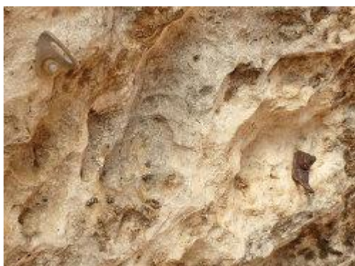
Ambiente altamente soggetto a corrosione, circa 3 metri dal mare. Un fix di acciaio zincato infisso nel 1989 e a fianco un inox più recente, con segni di ruggine vicino al dado. Photo by M. Oviglia
